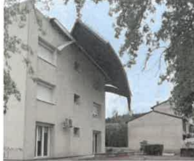
Une partie du toit était restée accrochée au bâtiment lors de la tempête du mois de juillet. Photo archives Margot Michel
